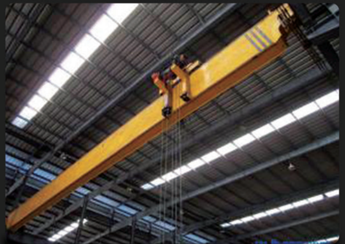
EOT CRANE - 5 TON
